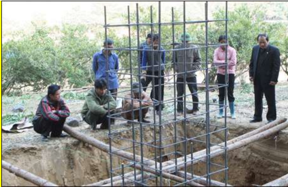
Nhưng ngày cuối năm, công tác cắm mốc đang tắt bật. Chủ Tịch tỉnh Cao Bằng Lô Ích Giang (bìa phải) thân chinh đến kiểm tra, đốc thúc công việc xây dựng cột mốc mới.
